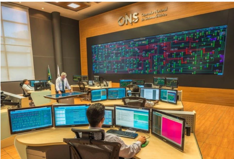
Figura 4: Centro Regional de Operação Sul Florianópolis. Fonte: http://www.ons.org.br
